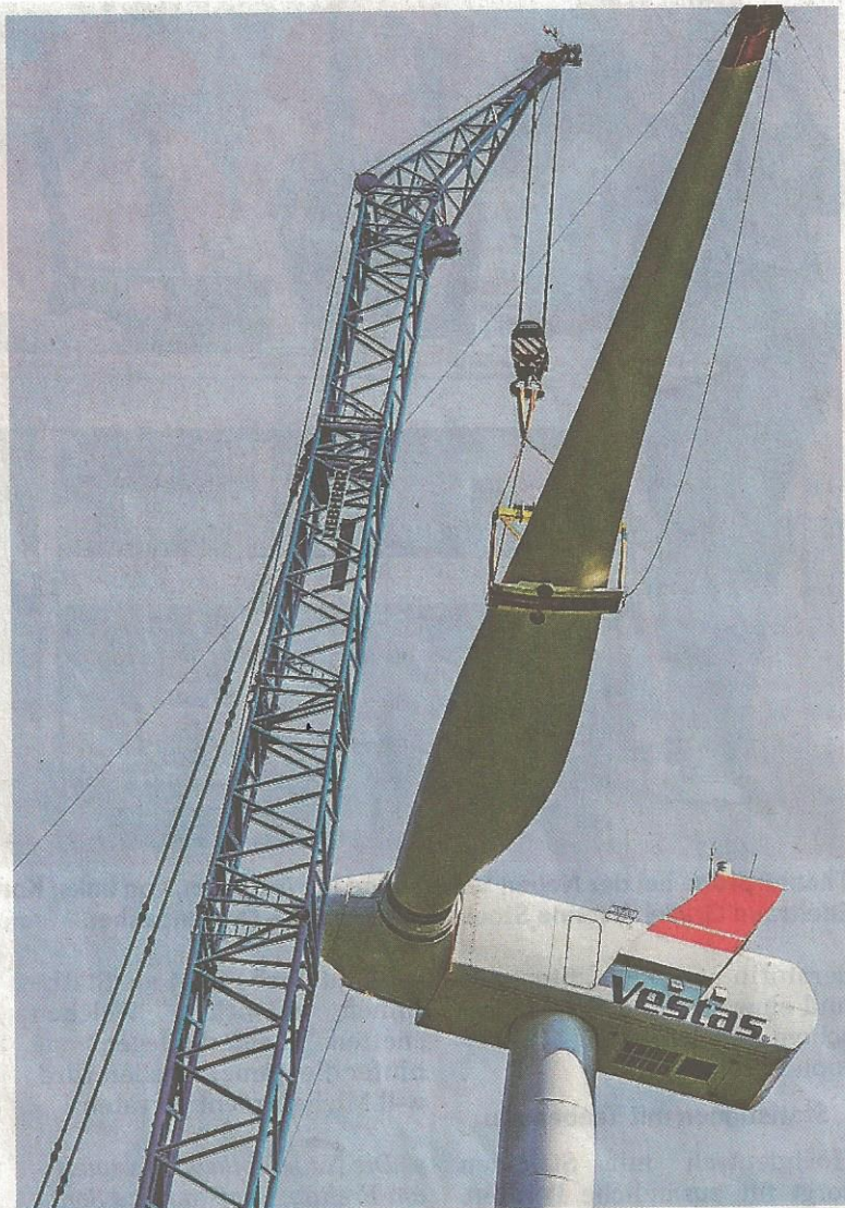
Nahe Losheim wird ein Windrad montiert. Ob auch mal im Fröhner Wald die Windkraft eingefangen wird, ist offen. FOTO: ROLF RUPPENTHAL
